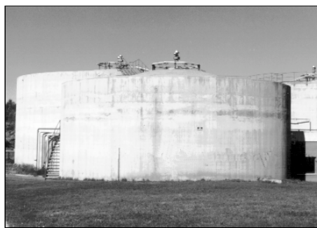
Digestores primarios, donde se lleva a cabo la digestión anaeróbica.
