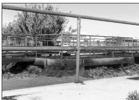
Cubas de aireación de los residuos, ya en el tratamiento secundario biológico.
