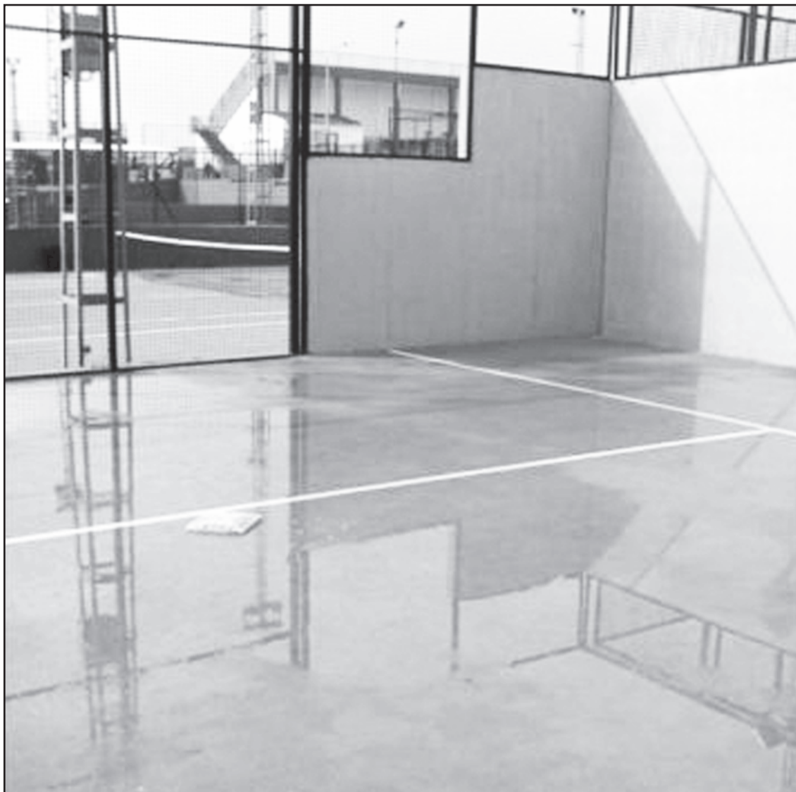
Las pistas quedan alagadas cuando llueve al no haber una canalización para el desagüe
