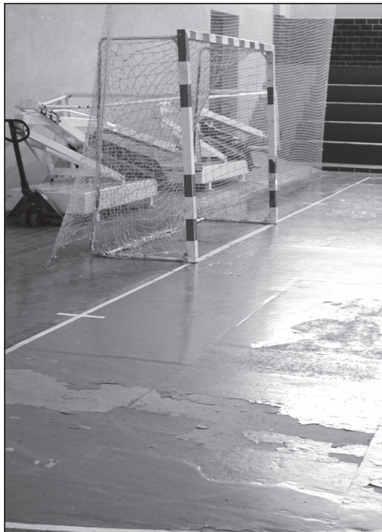
Estado del parqué del polideportivo
