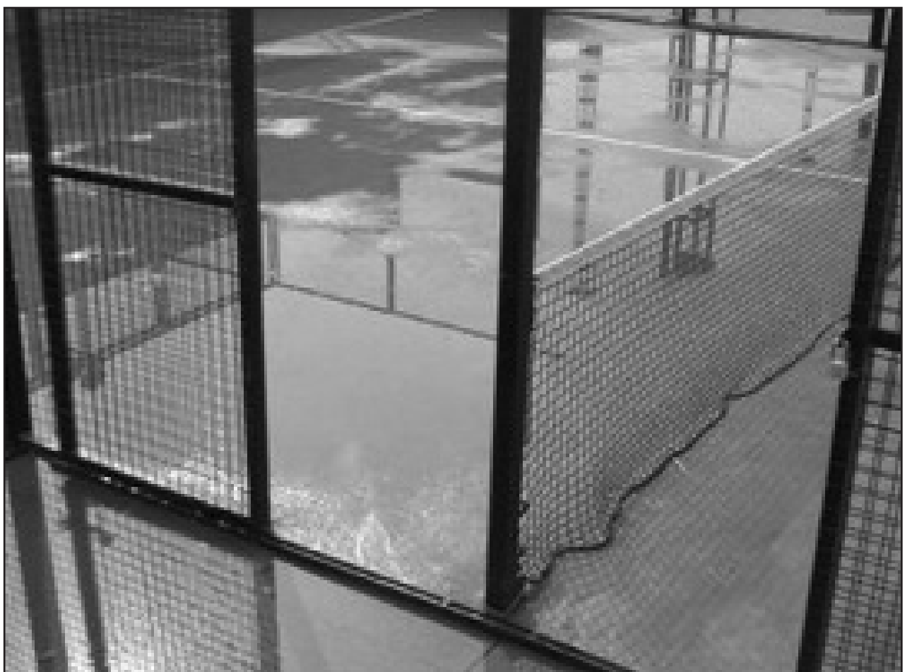
Cuando llueve, las pistas de padel se halagan, debido a la falta de un desagüe en el pasillo que da acceso a las mismas
