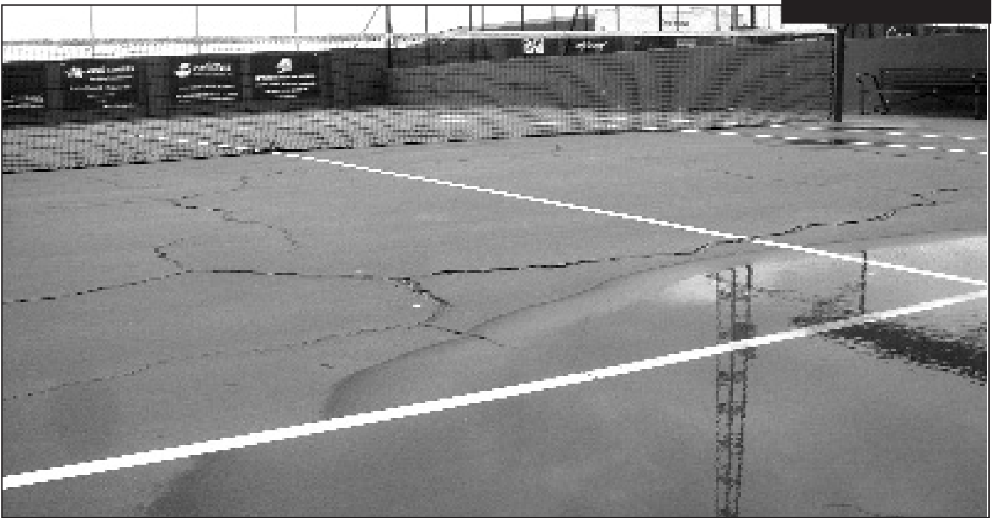
Las grietas y los charcos son habituales en las pistas de tenis
