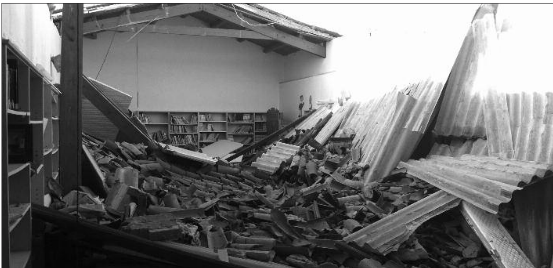
Así quedó la biblioteca infantil tras el derrumbe
