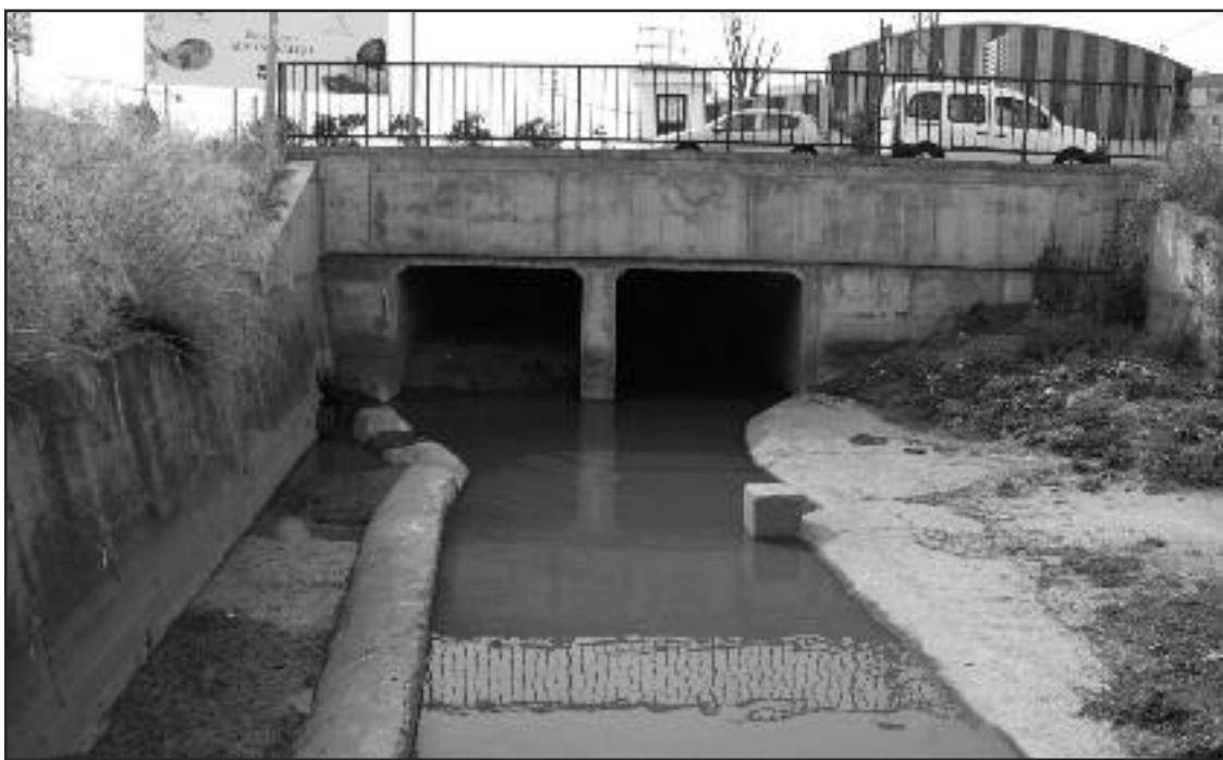
Aliviadero del Charnecal, colector de la carretera de Badajoz
