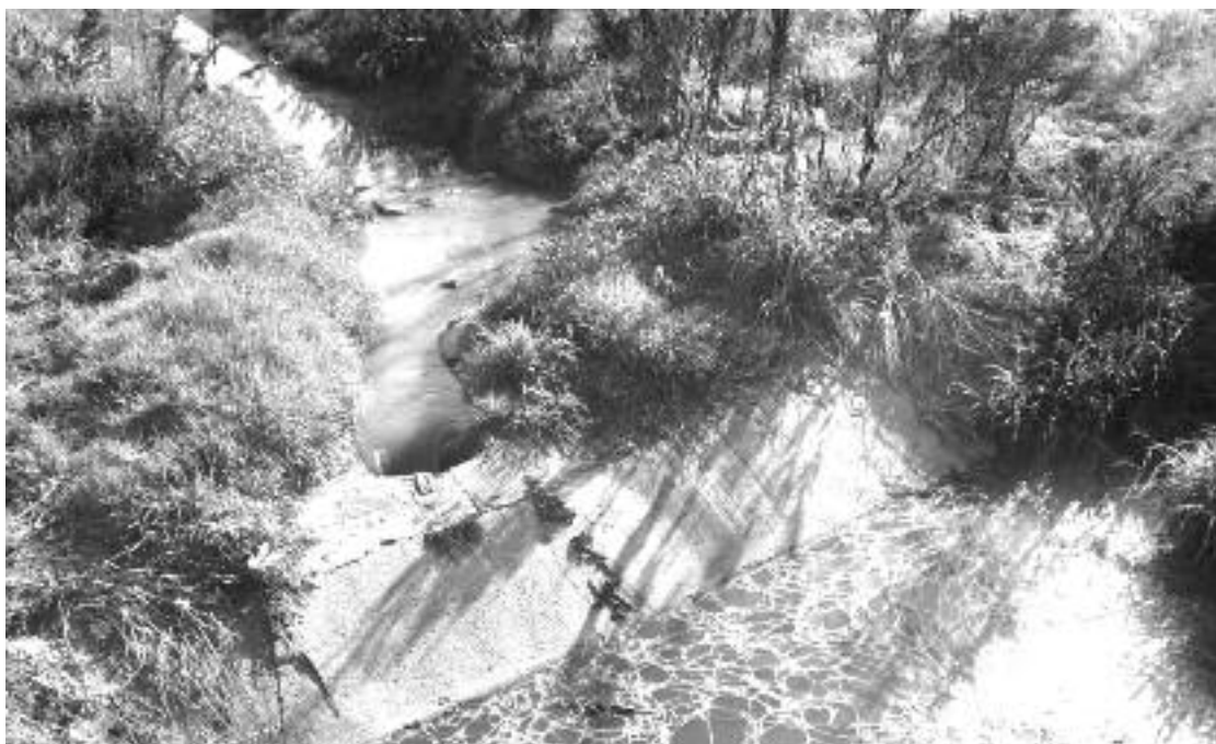
El colector sufre desde hace años roturas por su mal estado.
