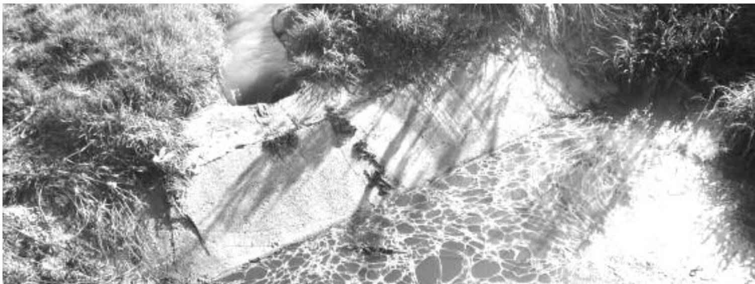
Se han producido numerosas roturas del colector en los últimos años.
