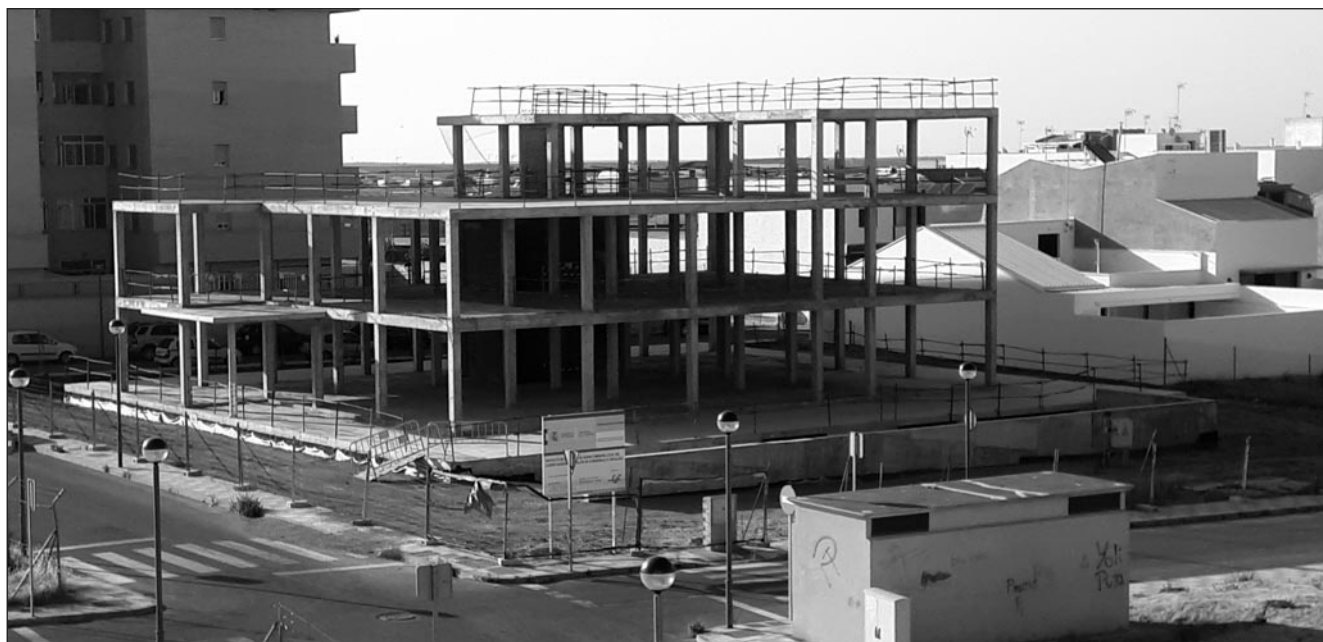
Estado en el que ha quedado la obra de la comisaría tras paralizarse su ejecución.
