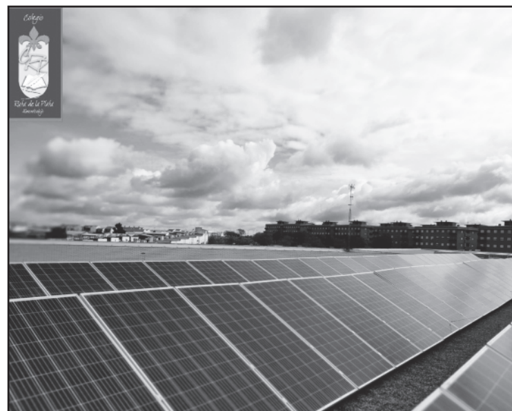
Placas fotovoltaicas instaladas en el colegio. FOTO: Ruta de la Plata
