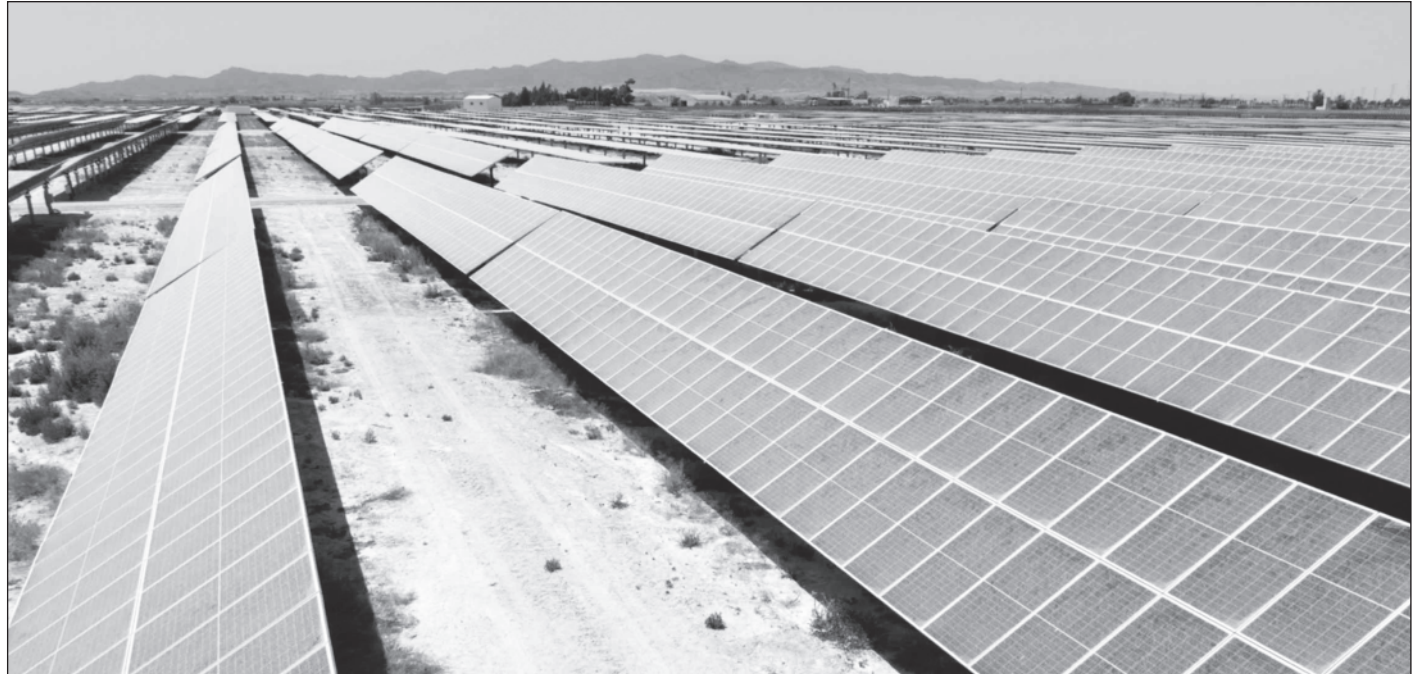
Paneles de una planta gestionada por Endesa, similar a las que se construirán en los términos municipales de Almendralejo y Mérida.
