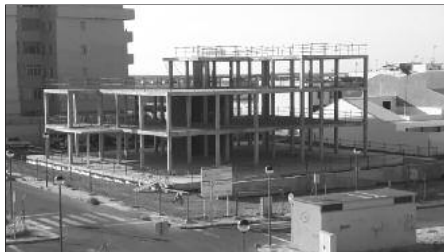
Estructura de la nueva comisaría, cuyas obras se paralizaron.
