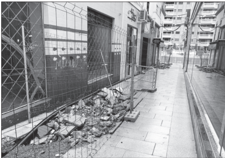
Pavimento levantado de la calle Peces, tras una avería.
