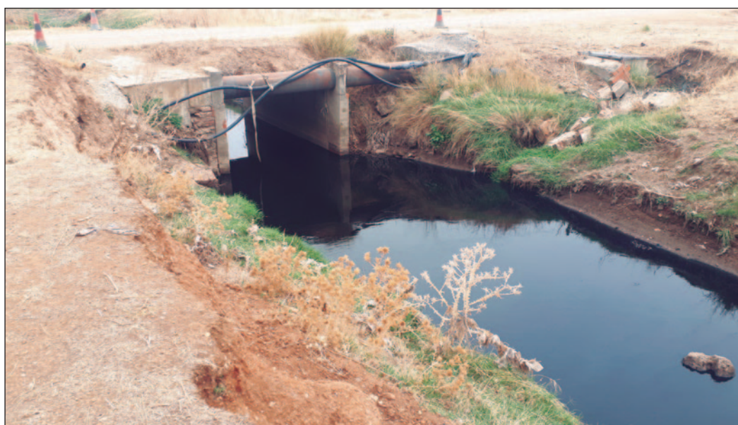
Vertidos en una parte del arroyo Las Pícdas por la rotura del colector.
